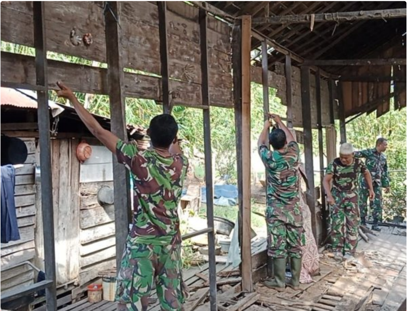
Hari ke Dua Bantuan Rehab RTLH Kodim 1006/Bjr, Bangun Tiang dan Rangka Rumah
